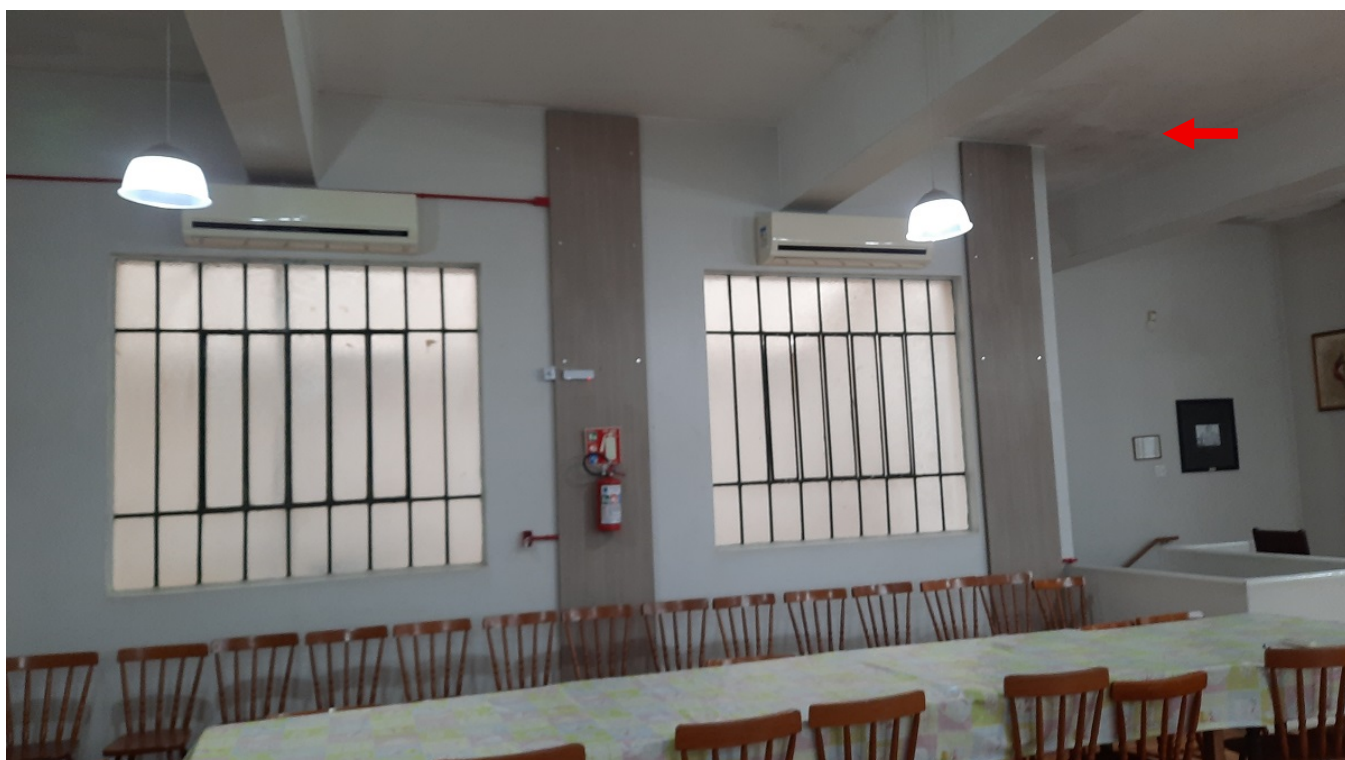
Figura 72: Manchas de umidade na laje de teto do Salão Social. Fonte: FAGUNDES, Renata M. (2023).
