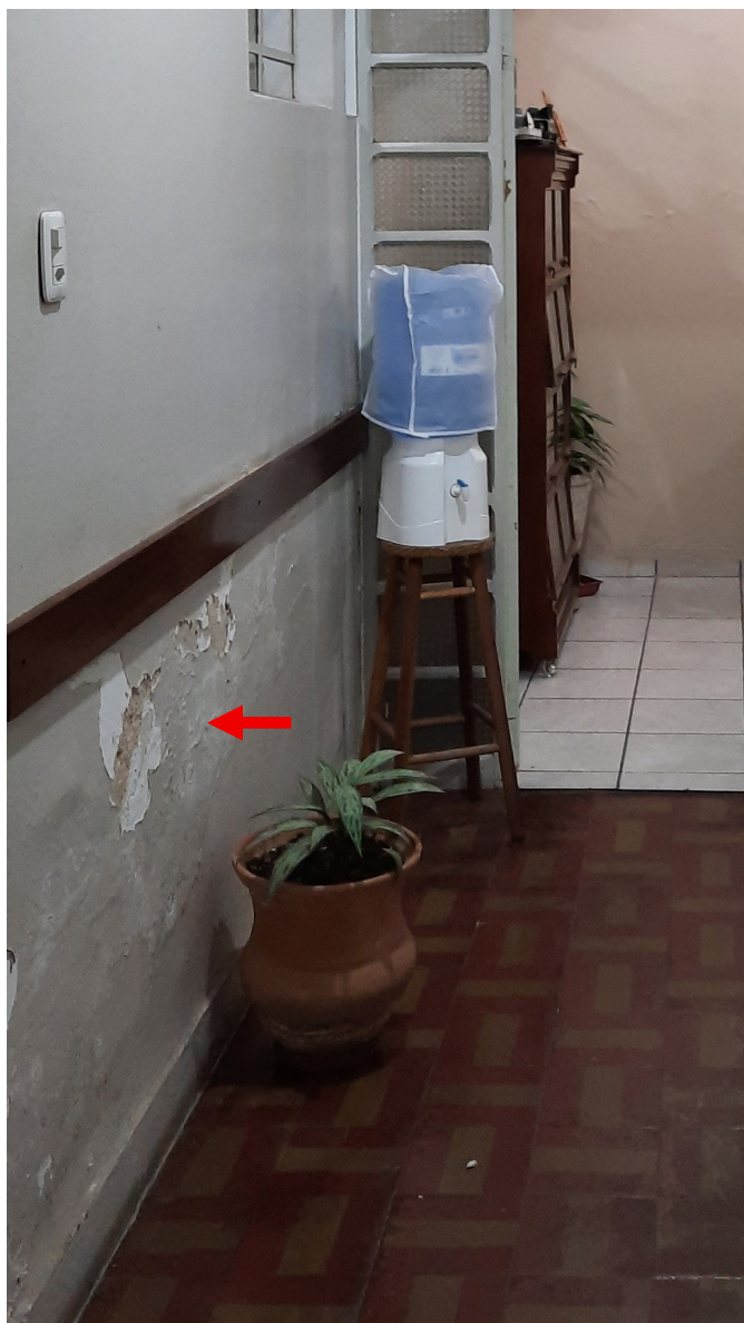
Figura 73: Descascamento de pintura no Edifício Educacional. Fonte: FAGUNDES, Renata M. (2023).
