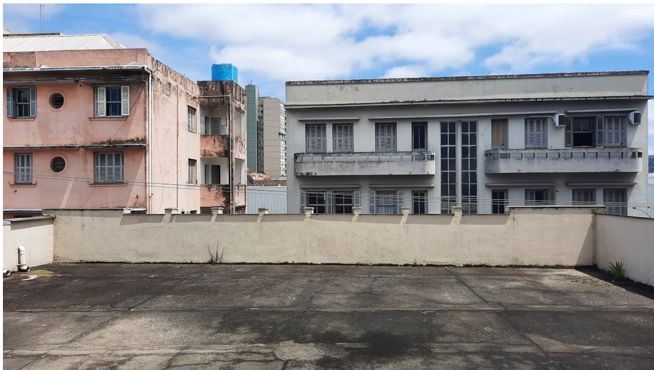
Figura 71: Vegetação, sujeidade e trincas no terraço do Edifício Educacional. Fonte: FAGUNDES, Renata M. (2023).
