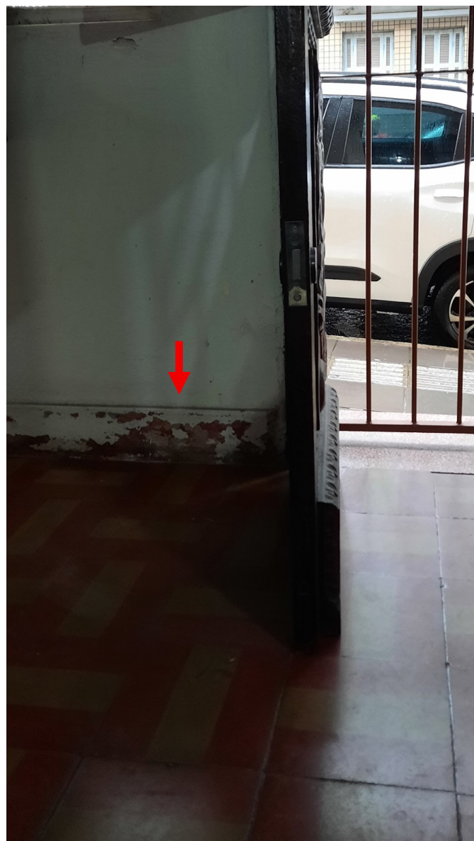
Figura 74: Rodapé de madeira deteriorado no Edifício Educacional. Fonte: FAGUNDES, Renata M. (2023).
