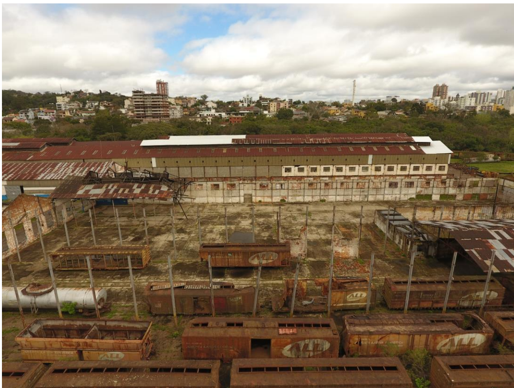
Figura 50 – A edificação está em processo de ruinação – Quase toda sem presença de coberturas, esquadrias, estruturas das treliças e pisos - Fonte: Silvio Fogaça (2018)
