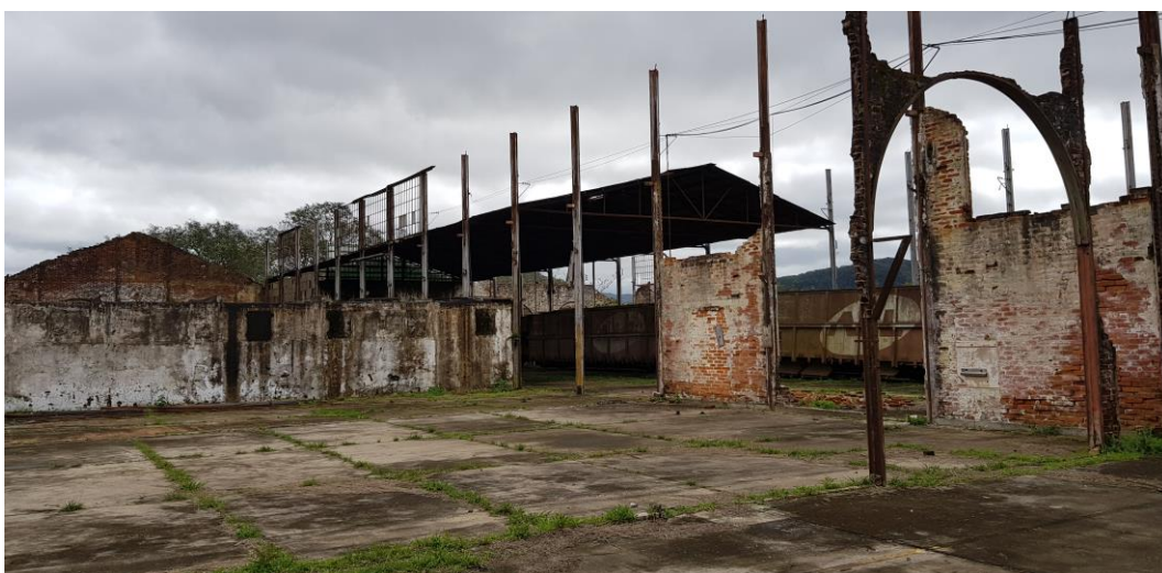
Figura 30 – Vista interna da antiga área de reparação de carros - Fonte: Silvio Fogaça (2018)
