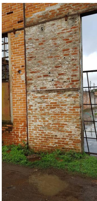
Figura 47 - Detalhe externo da amarração da alvenaria e perfis metálicos - Fonte: Varinia Schwartz (2018)
