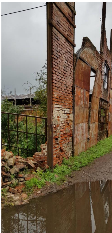
Figura 54 - A falta de cobertura do espaço faz com que pressões de vento atuem diretamente sobre a estrutura de painéis remanescentes, gerando grande risco de desabamento - Fonte: Silvio Fogaça (2018)
