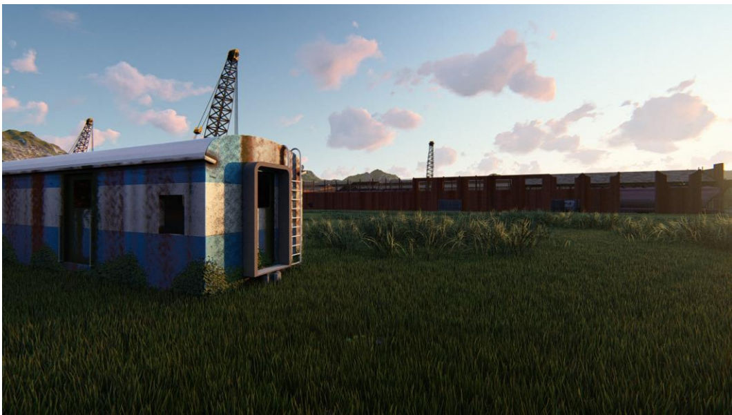
Figura 14 - Imagem ilustrativa das ruínas do edifício da Antiga Oficina de Carros de Passageiros – Fonte: Varínia Schwartz Arquitetura
