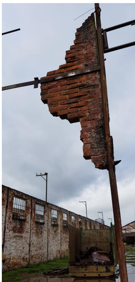
Figura 56 - O desprendimento dos blocos cerâmicos da estrutura metálica pode ocasionar danos materiais e corporais aos funcionários e visitantes - Fonte: Silvio Fogaça (2018)
