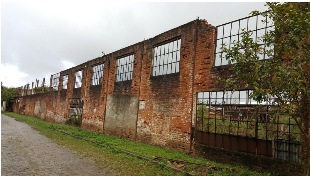
Figura 49 – Todas as esquadrias estão em sua maioria com perfis oxidados e vidros faltantes- Fonte: Varínia Schwartz (2018)
