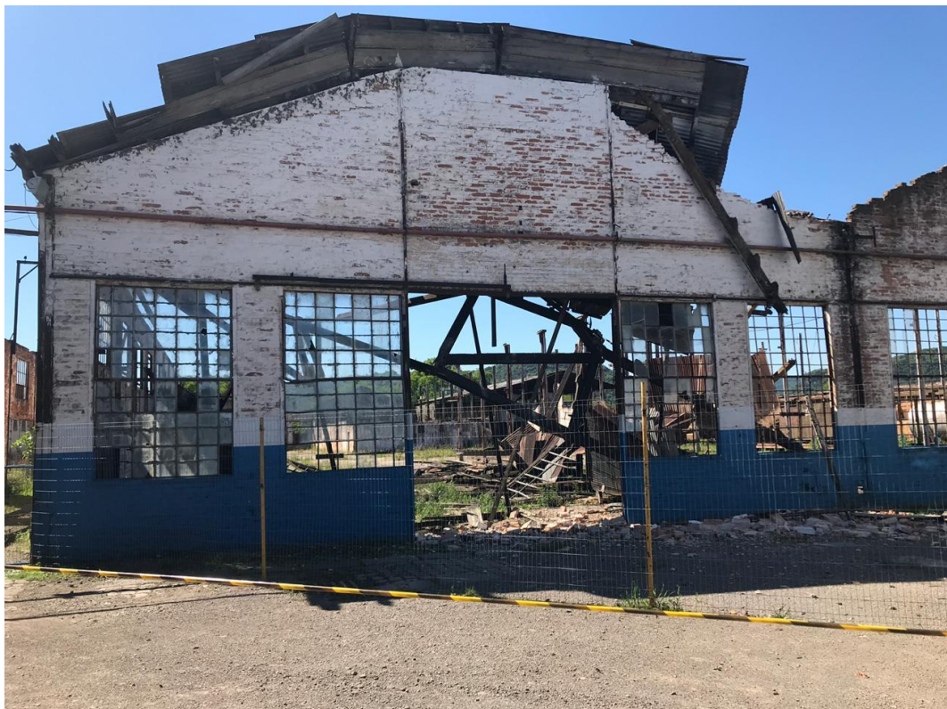
Figura 58 - Recentemente a cobertura da área da carpintaria entrou em colapso devido a fortes ventos que assolaram o complexo – Fonte: Rumo Logística (2018)
