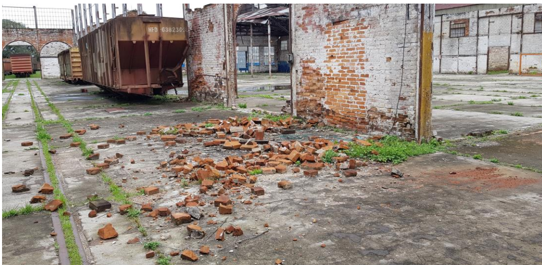
Figura 53 - O desprendimento constante dos blocos cerâmicos da alvenaria pode acarretar danos materiais e corporais aos funcionários e visitantes - Fonte: Silvio Fogaça (2018)
