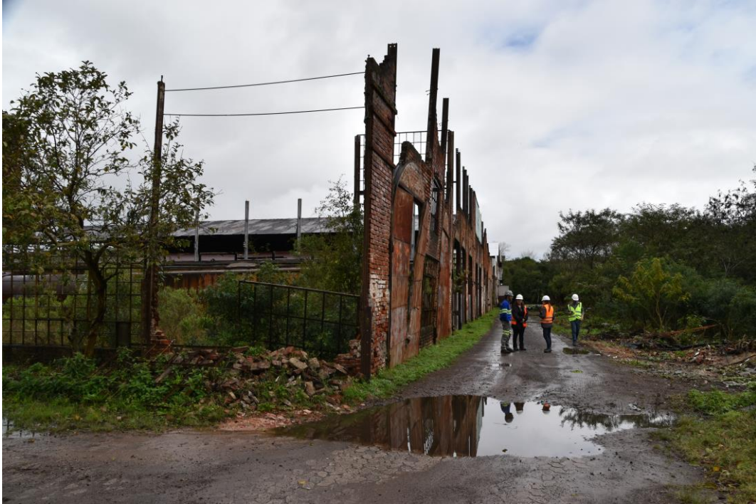
Figura 57 - A falta de cobertura do espaço faz com que pressões de vento atuem diretamente sobre a estrutura de painéis remanescentes, gerando grande risco de desabamento - Fonte: Silvio Fogaça (2018)
