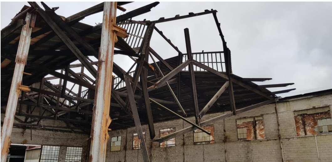
Figura 52 - Treliças de madeira e cobertura da antiga área de carpintaria em colapso - Fonte: Silvio Fogaça (2018)
