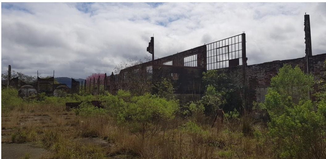
Figura 33 - Vista interna da antiga área de reparação de carros - Fonte: Silvio Fogaça (2018)
