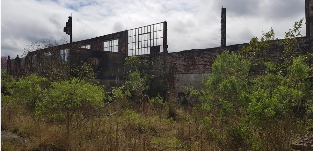
Figura 51 - A pavimentação de concreto está deteriorada e apresentando rachaduras, frestas e disseminação de espécies vegetais - Fonte: Silvio Fogaça (2018)
