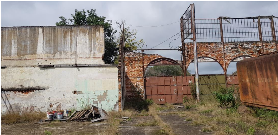
Figura 55 - A oxidação de todos os elementos metálicos da estrutura fragiliza a capacidade de sustentação da mesma, podendo acarretar em colapso dos painéis – Fonte: Silvio Fogaça (2018)
