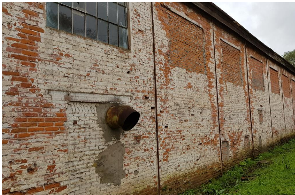
Figura 63 - Fechamento dos vãos das esquadrias, heterogeneidade dos materiais e descaracterização da configuração original – Fonte: Silvio Fogaça (2018)
