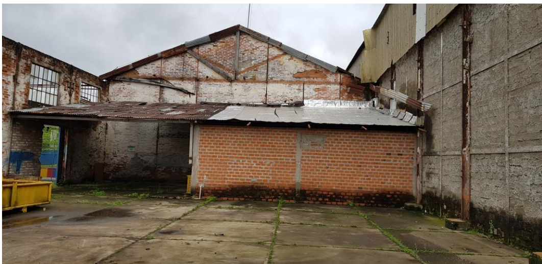
Figura 52 - Detalhe interno da área de ruínas da antiga ferramentaria da oficina de vagões - apêndice construído posteriormente ao colapso - Fonte: Silvio Fogaça (2018)
