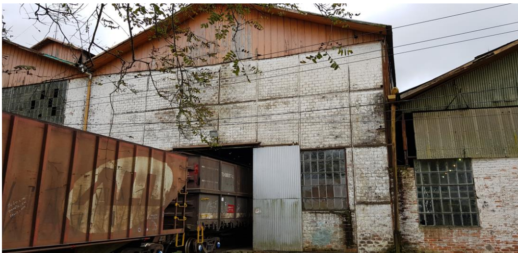
Figura 59 - Madeiras do fechamento dos oitões e beirais deteriorados por ações do tempo e umidade - Fonte: Silvio Fogaça (2018)
