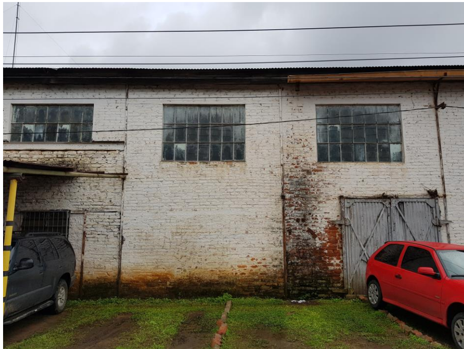
Figura 58 - Diversos pontos da fachada com manchas e fissuras causadas por umidade accidental (umidade causada por vazamentos e calhas) - Fonte: Silvio Fogaça (2018)
