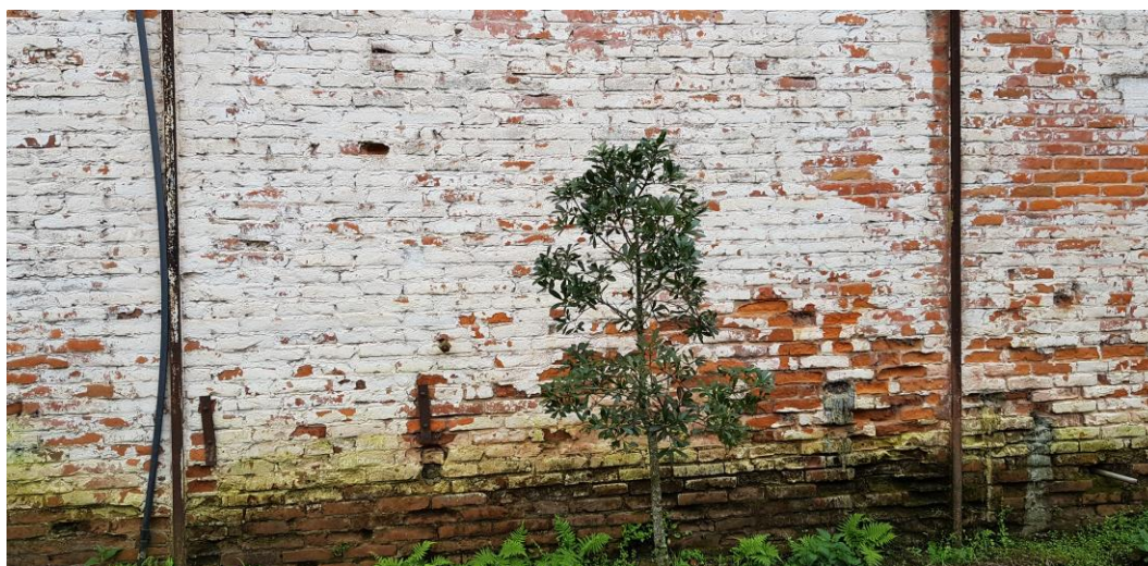
Figura 64 - Manchas e deterioração das alvenarias devido a umidade ascendente - Fonte: Silvio Fogaça (2018)
