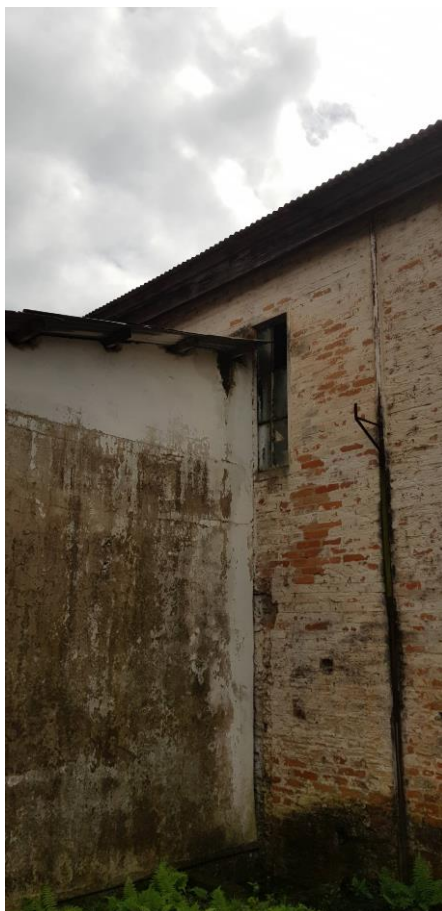
Figura 67 - Construção de apêndices descaracterizou elementos da arquitetura original - Fonte: Silvio Fogaça (2018)
