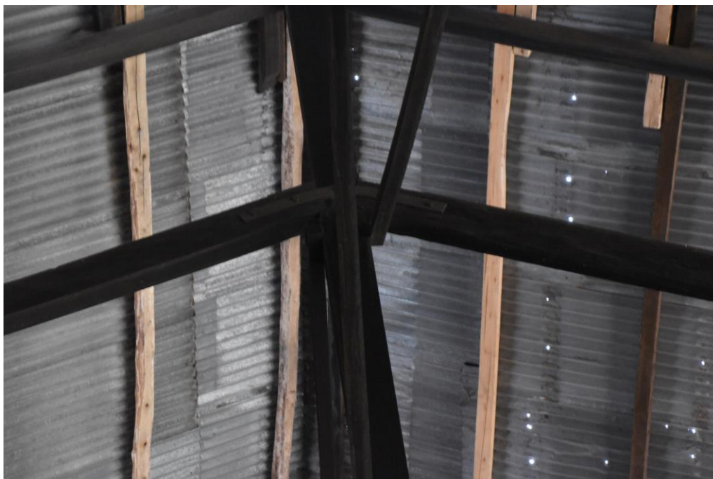
Figura 72 - Parte da estrutura de madeira ruiu e foi substituída por peças não uniformes de madeira - Fonte: UP3D Imagens (2018)
