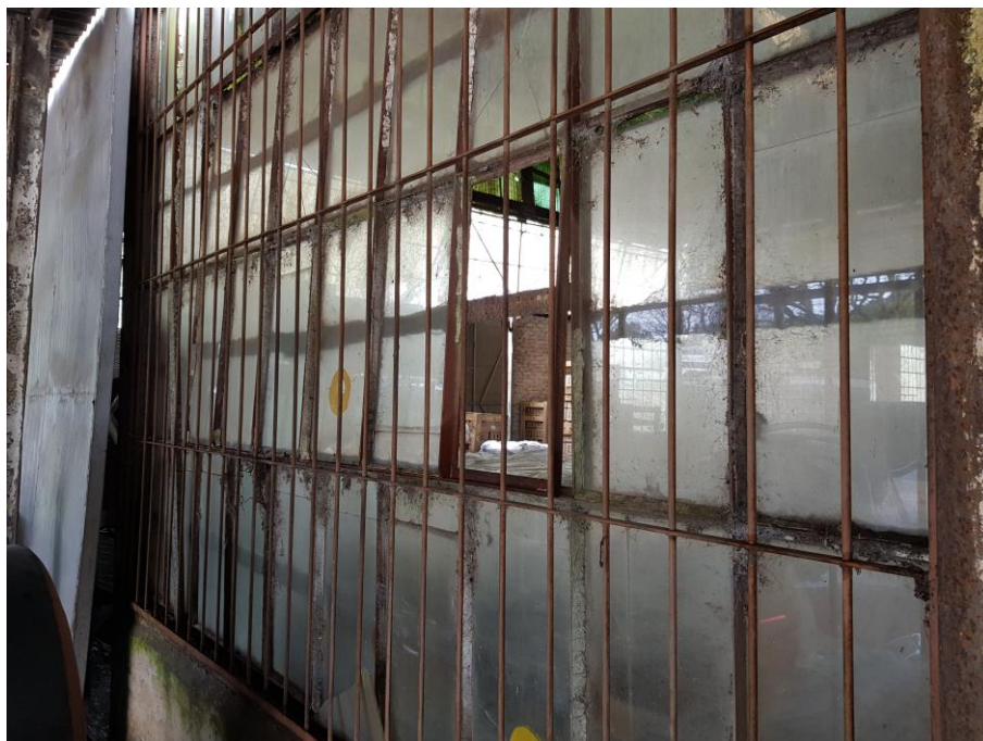
Figura 57 - As esquadrias estão em sua maioria com perfis oxidados, vidros faltantes, quebrados ou despadronizados - Fonte: Silvio Fogaça (2018)
