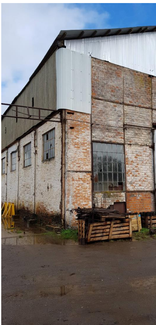
Figura 42 - Detalhe externo do fechamento da fachada em chapa metálica em substituição as antigas esquadrias metálicas - Fonte: Silvio Fogaça (2018)
