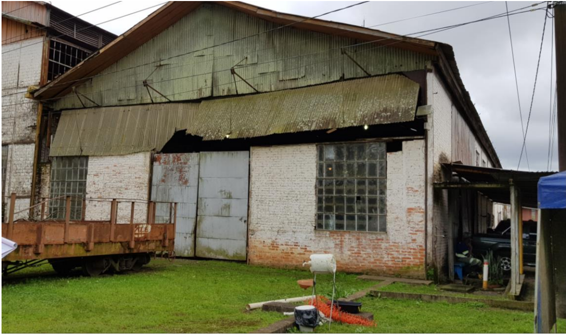
Figura 61 - Fechamento em telha de propileno em condições precárias - descaracterizado em relação ao projeto original - Fonte: Silvio Fogaça (2018)
