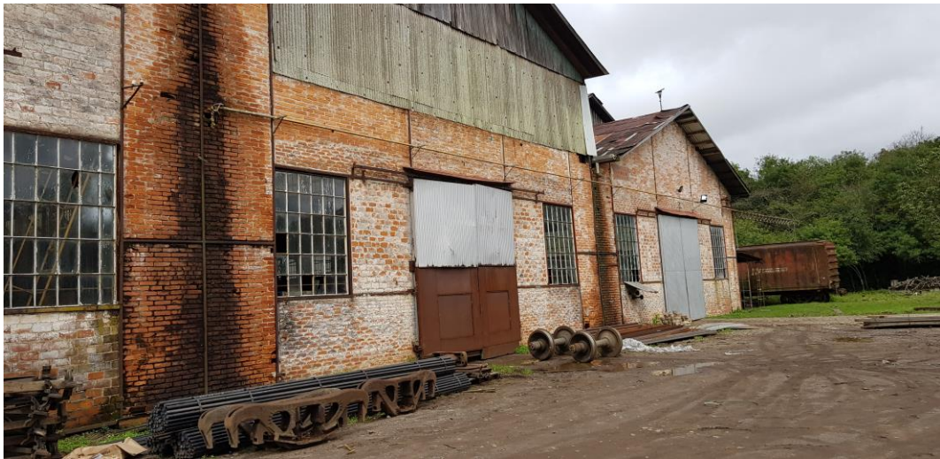
Figura 69 - As intervenções realizadas no decorrer dos anos e a heterogeneidade dos materiais descaracterizaram completamente o projeto original - Fonte: Silvio Fogaça (2018)
