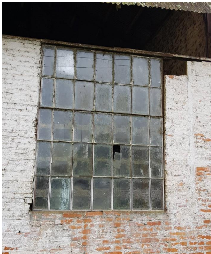
Figura 43 - Detalhe externo da esquadria metálica com painéis de vidro - Fonte: Silvio Fogaça (2018)
