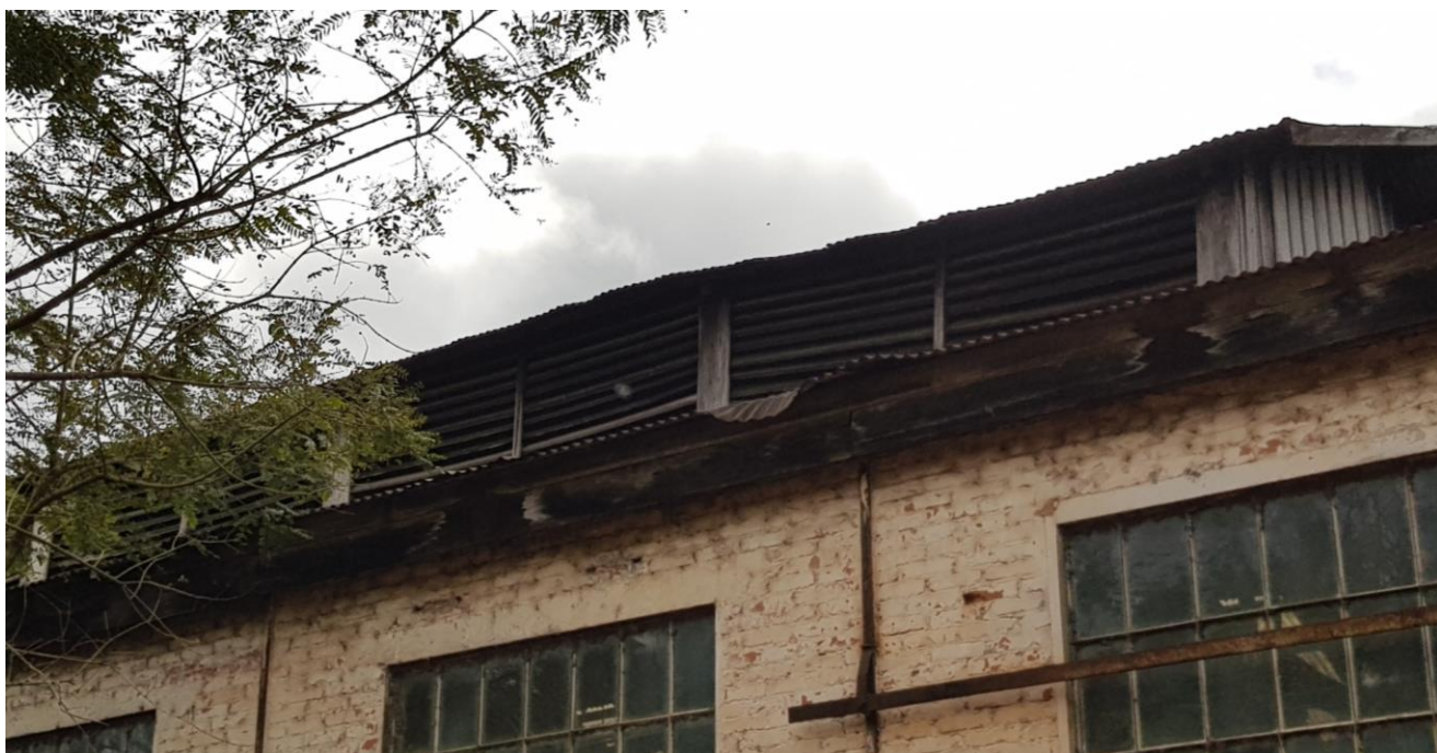
Figura 68 - As venezianas de madeira dos lanternins estão em péssimas condições - a madeira esta deteriorada por umidade devido a exposição a intempéries - Fonte: Silvio Fogaça (2018)
