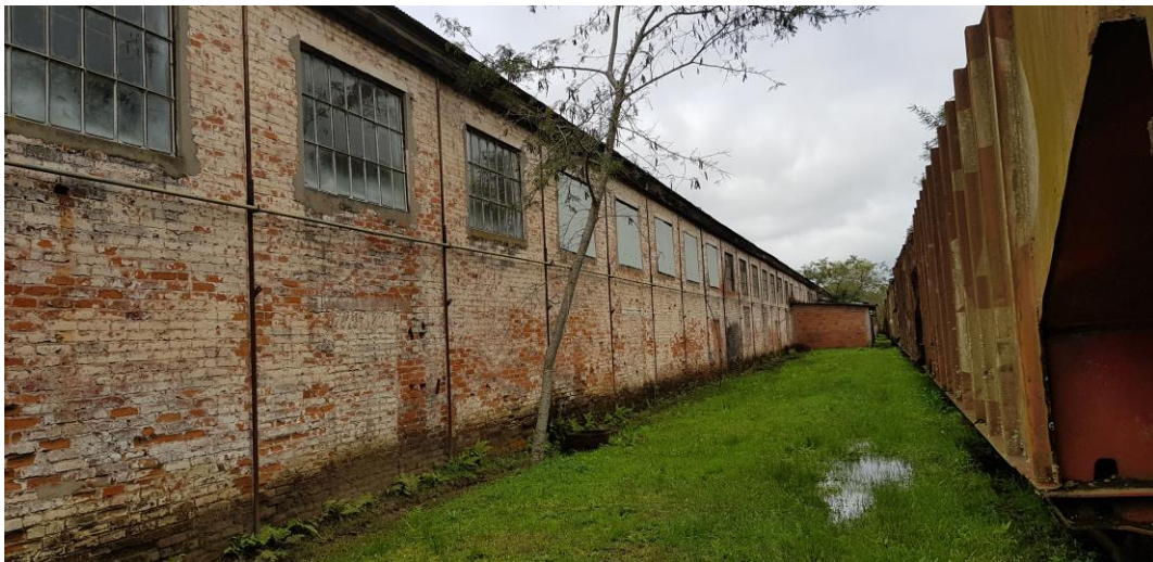
Figura 51 - Detalhe externo da modulação dos painéis de alvenaria e esquadrias - Fonte: Silvio Fogaça (2018)
