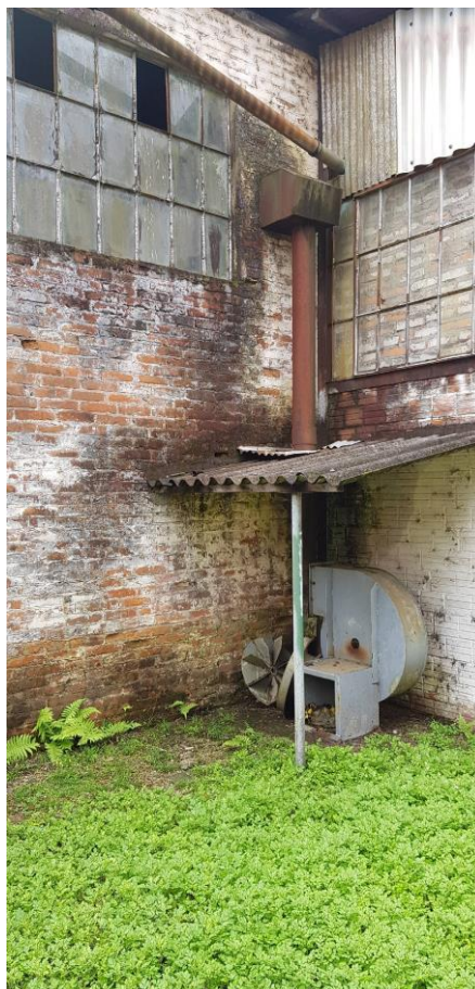
Figura 66 - Instalações de apêndices e soluções provisórias que denegrem a arquitetura da edificação. – Fonte: Silvio Fogaça (2018)
