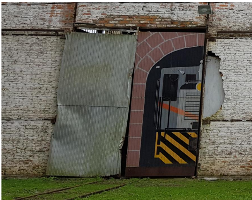
Figura 62 - Fissuração e colapso das paredes de alvenaria - Fonte: Silvio Fogaça (2018)
