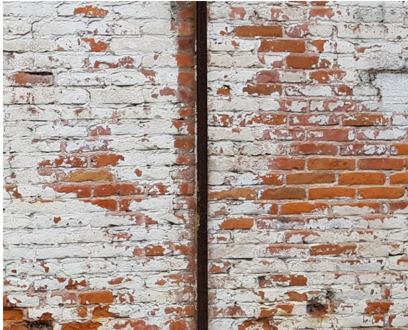
Figura 65 - Perfis estruturais dos painéis da alvenaria oxidados - Fonte: Silvio Fogaça (2018)
