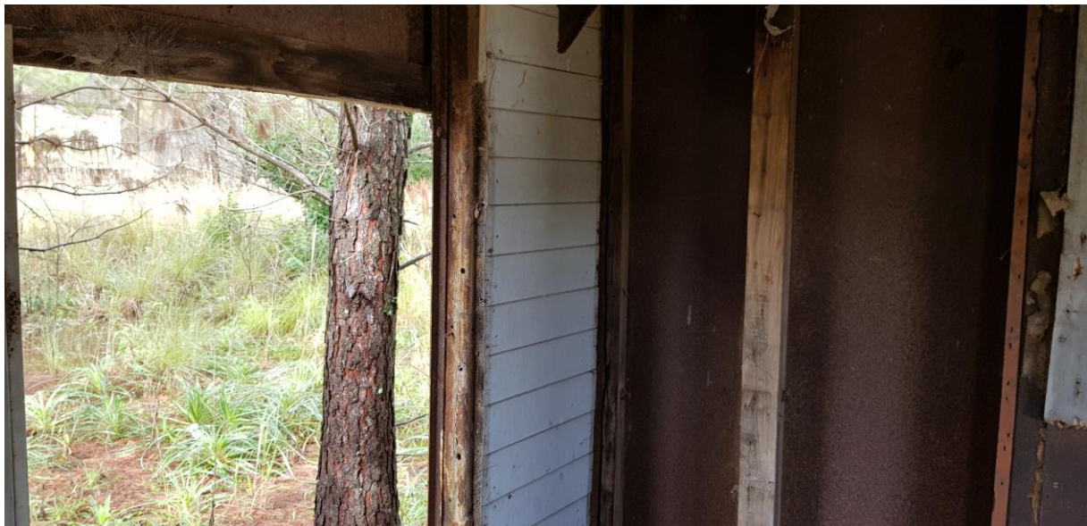
Figura 16 - Paredes sem revestimento - Estrutura Oxidada- Fonte: Silvio Fogaça
