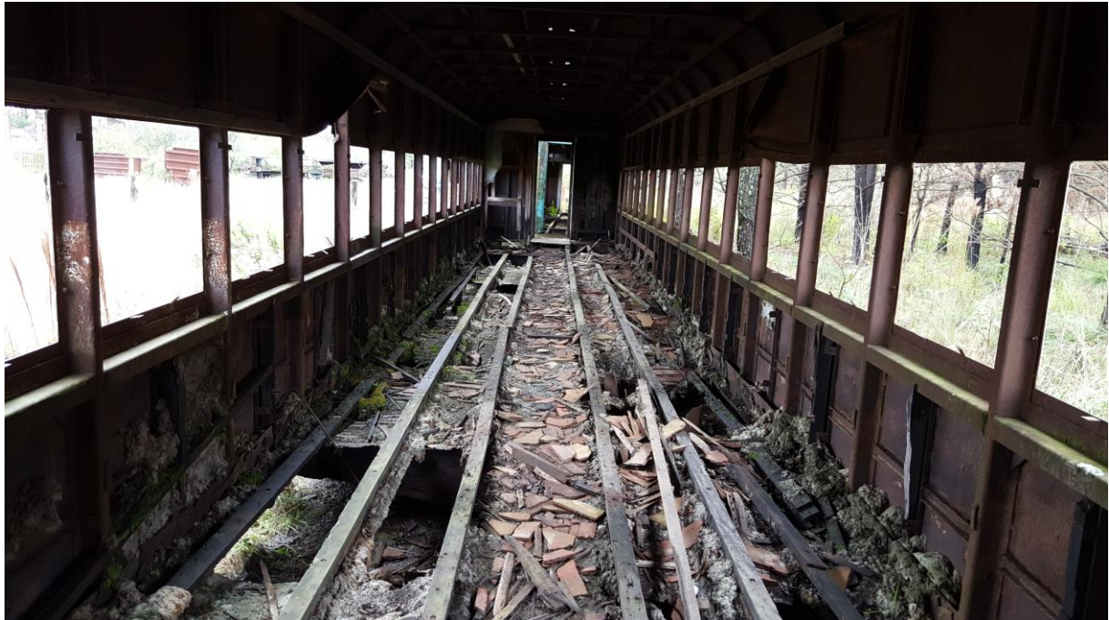
Figura 19 – Estrutura comprometida, oxidada, queimada, torcida e recortada – Sem painéis de revestimento de piso, teto e parede – esquadrias inexistentes. Fonte: Varinia Schwartz
