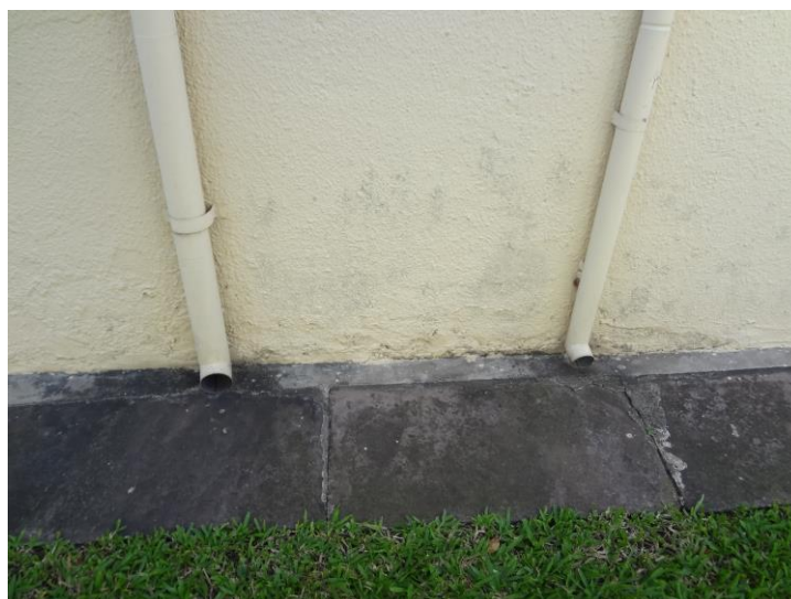
Figura 07: Tubo de queda em pvc direcionadas para o jardim, lateral da Igreja, Fachada Sudeste. Fonte: arquivo pessoal Janice Peiter (2015)
