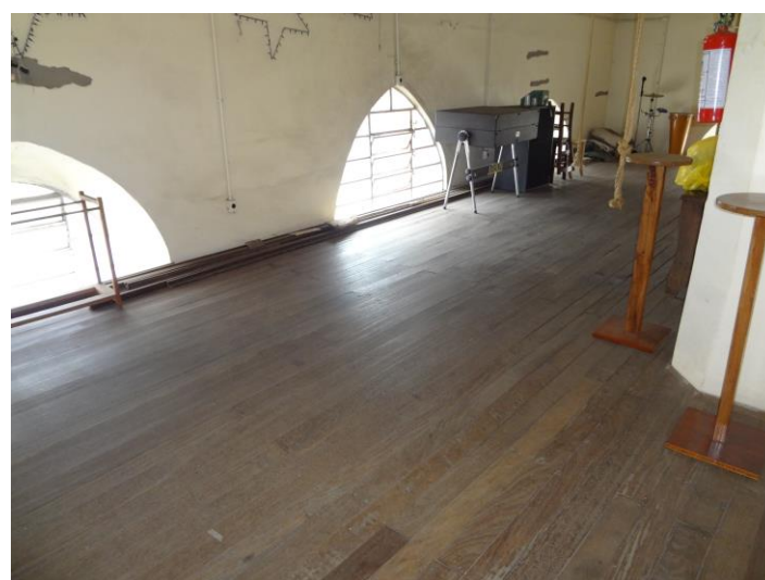
Figura 52: Esquadrias da Fachada principal interrompidas pelo piso em madeira do coro. Fonte: arquivo pessoal Janice Peiter (2015)
