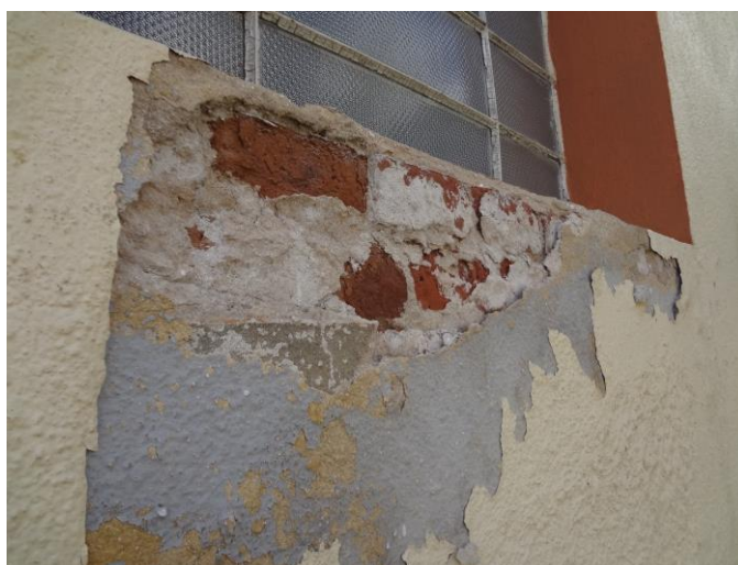
Figura 55: Degradação do reboco externo abaixo da janela da fachada Sudoeste, rua Cel. Niederauer. Fonte: arquivo pessoal Janice Peiter (2013)
