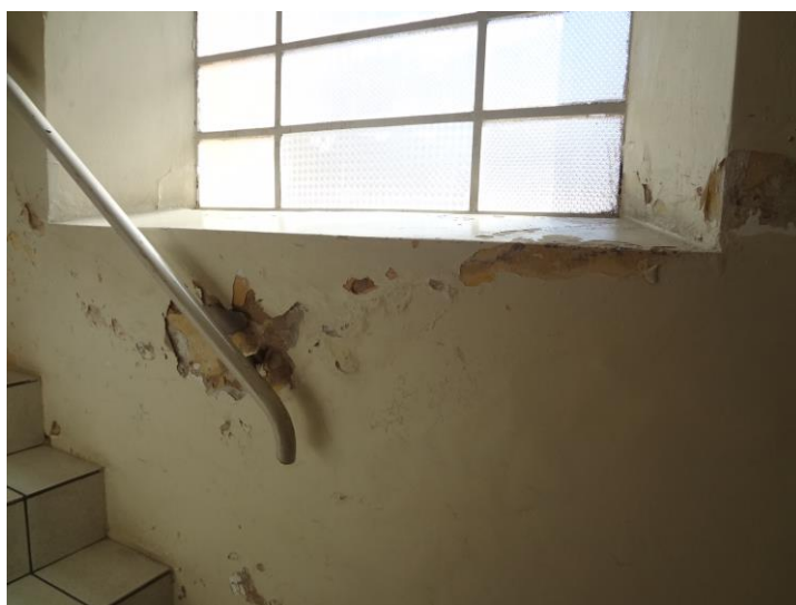
Figura 64: Degradação do reboco interno, parede de acesso à escada do coro. Fonte: arquivo pessoal Janice Peiter (2013)
