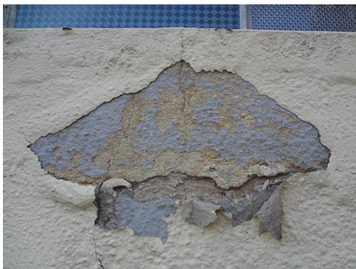
Figura 56: Degradação do reboco externo abaixo da janela da fachada Sudoeste, rua Cel. Niederauer. Fonte: arquivo pessoal Janice Peiter (2013)
