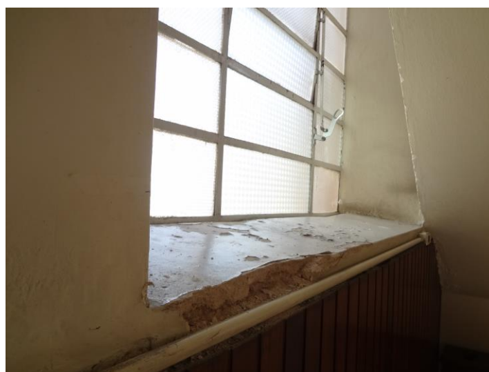
Figura 61: Degradação do reboco e pintura, peitoril da janela lado interno, sob a escada. Fonte: arquivo pessoal Janice Peiter (2013)
