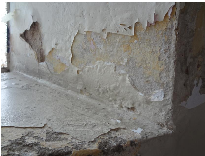
Figura 66: Degradação do reboco interno, janela do lado direito do Templo. Fonte: arquivo pessoal Janice Peiter (2013)
