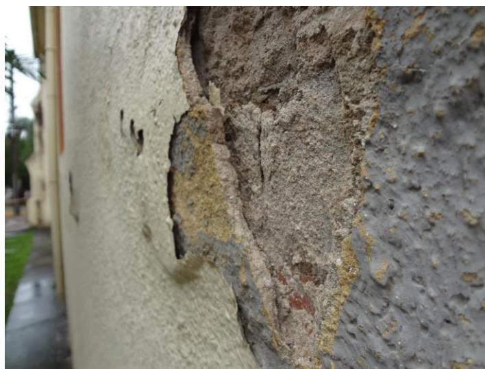
Figura 57: Degradação do reboco externo, fachada Sudoeste, rua Cel. Niederauer. Fonte: arquivo pessoal Janice Peiter (2013)
