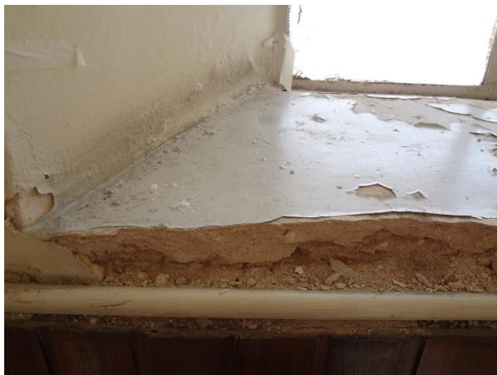
Figura 62: Degradação do reboco e pintura, peitoril da janela lado direito interno, sob a escada. Fonte: arquivo pessoal Janice Peiter (2013)
