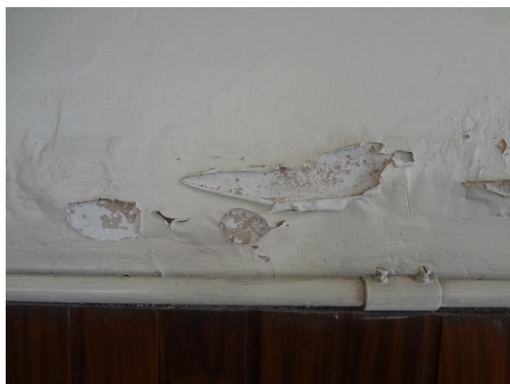
Figura 60: Degradação do reboco e pintura, parede interna, lateral direita do Templo. Fonte: arquivo pessoal Janice Peiter (2013)
