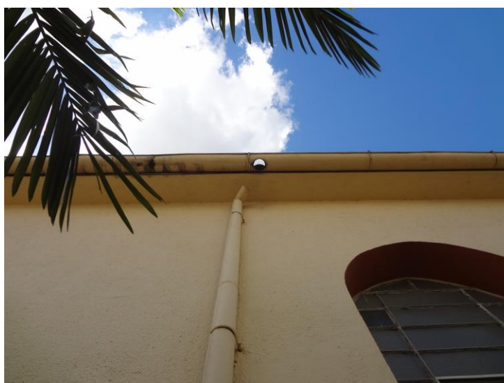
Figura 08: Calha e tubo de queda em pvc direcionadas em mau estado, lateral da Igreja, Fachada Sudeste. Fonte: arquivo pessoal Janice Peiter (2015)
