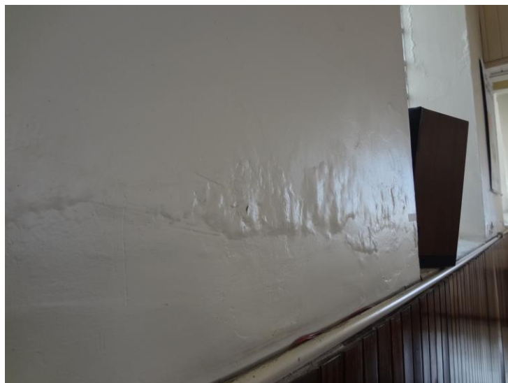
Figura 59: Degradação do reboco e pintura, parede interna, lateral direita do Templo. Fonte: arquivo pessoal Janice Peiter (2013)
