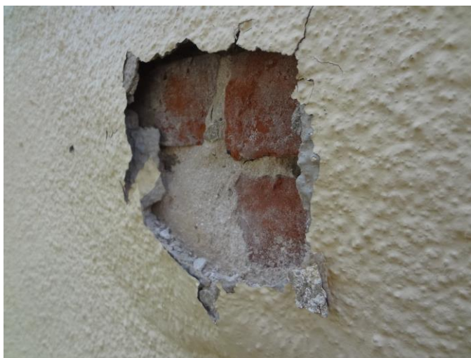
Figura 54: Degradação do reboco externo da fachada Sudoeste, rua Cel. Niederauer. Fonte: arquivo pessoal Janice Peiter (2013)
