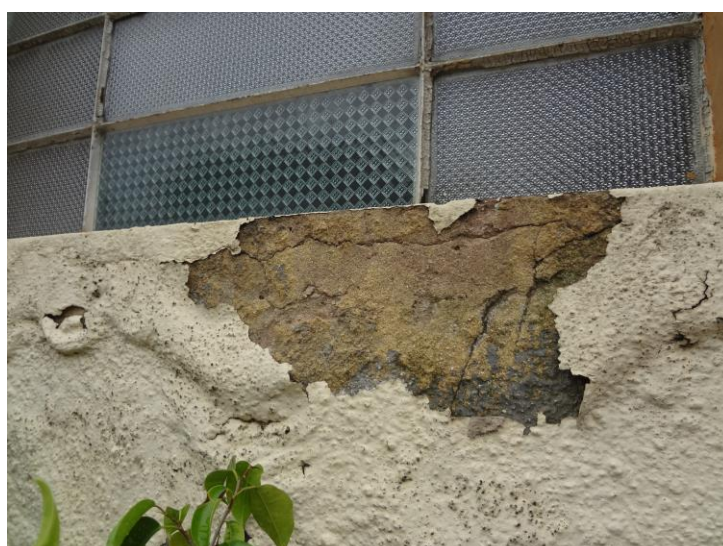
Figura 58: Degradação do reboco externo fachada principal, rua Barão do Triunfo. Fonte: arquivo pessoal Janice Peiter (2013)
