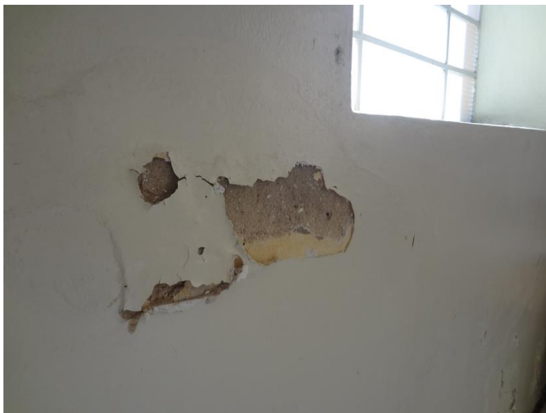
Figura 65: Degradação do reboco e pintura, hall de acesso, parede interna da fachada principal. Fonte: arquivo pessoal Janice Peiter (2013)
