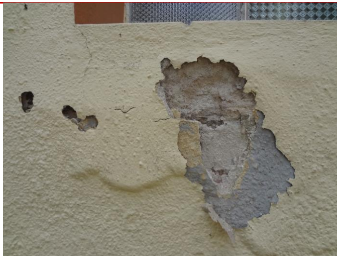
Figura 53: Degradação do reboco externo abaixo da janela da fachada Sul, rua Cel. Niederauer. Fonte: arquivo pessoal Janice Peiter (2013)
