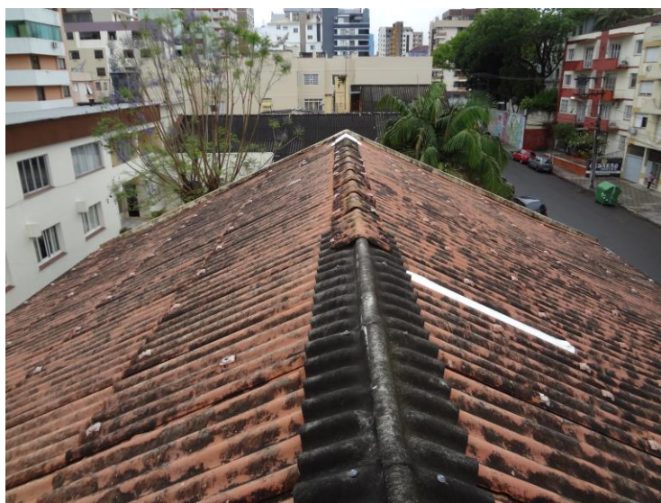
Figura 16: Telhado em fibroamianto, vista da torre dos sinos. Fonte: arquivo pessoal Janice Peiter (2015)
