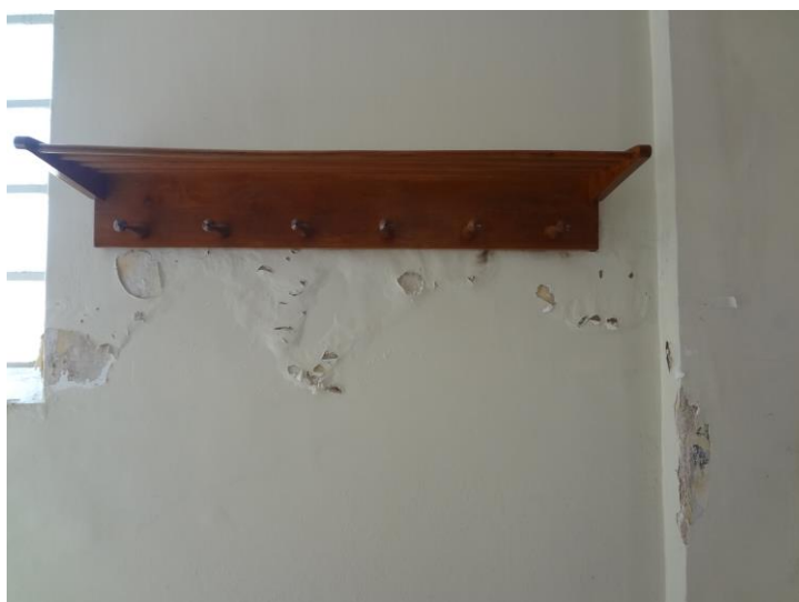
Figura 63: Degradação do reboco e pintura, hall de acesso, parede interna da fachada principal. Fonte: arquivo pessoal Janice Peiter (2013)
