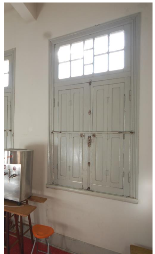
Figura 30: J04 - Janela vista internamente, pav. térreo. Fonte: Schneider. G.(2014)
