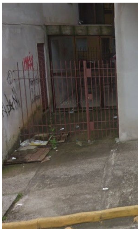
Figura 38: Acesso à edificação Rua Floriano Peixoto – Modificações existentes. Fonte: Ludtke, Elke (2017)
