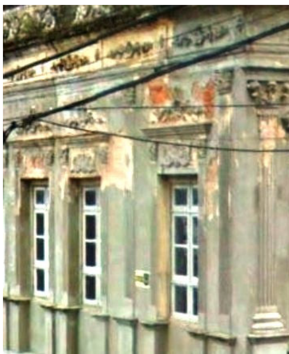
Figura 62: Fachada Sul desgastada na pintura e no reboco em vários pontos. Fonte: Ludtke, Elke. (2017)
