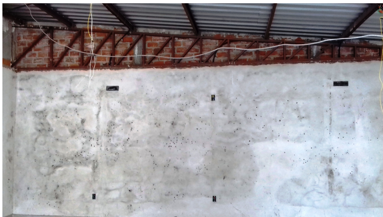
Figura 44: Cobertura – Substituição devido a vários focos de infiltração. Fonte: Ludtke, Elke. (2017)
