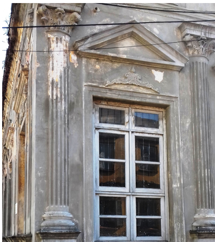
Figura 63: Fachada Leste desgastada na pintura e no reboco nas colunas e demais locais. Fonte: Ludtke, Elke. (2017).
