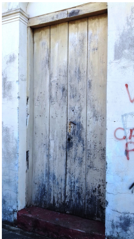
Figura 60: Porta externa danificadas com madeiramento desgastado. Fonte: Ludtke, Elke. (2017)
