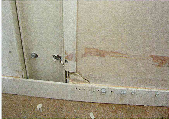
Foto 13 – Painel danificado, furado, remendado
