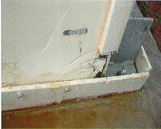
Foto 01 – Painel recortado, sapata oxidando
