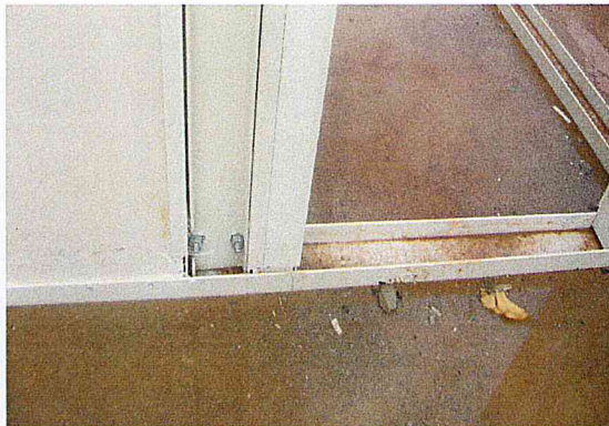
Foto 09 – Fixação painel fora de posição
